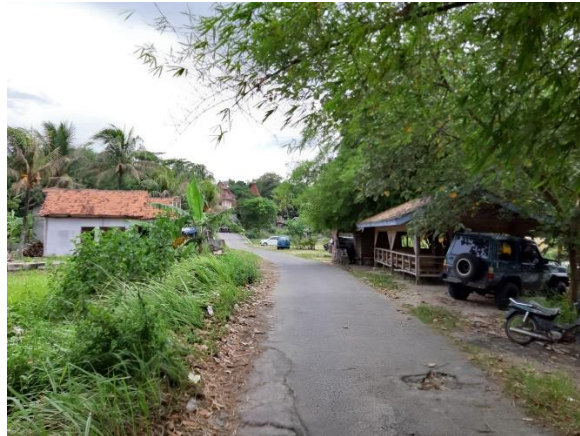
Gambar 10. Akses jalan yang rusak di Telaga Biru
